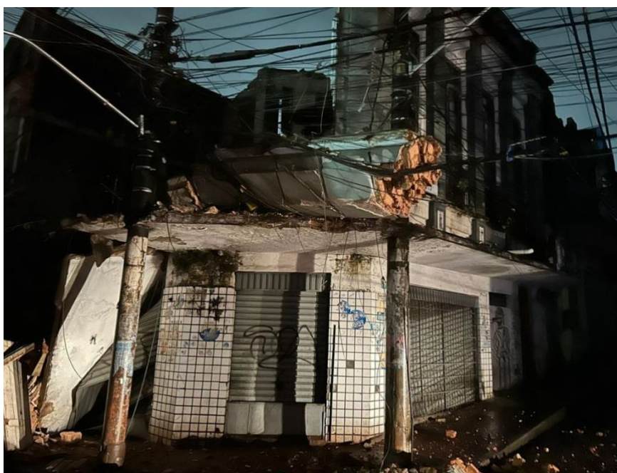
Fotografia 2: Desabamento de prédio comercial – Baixa de Sapateiros
